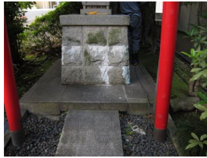
1. 施工前 エフロとカビ汚れが付着
