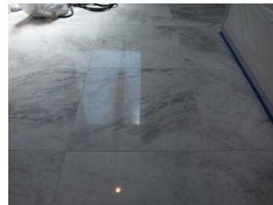
1. 養生テープによる表層剥離
