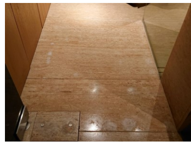
1. 塩素による石の劣化
