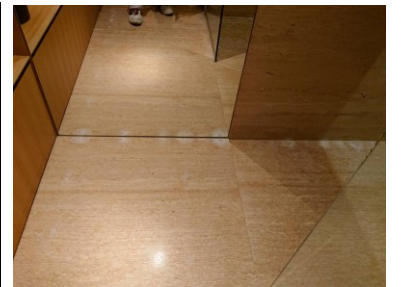
2. 塩素による石の劣化
