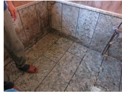
1. 壁に黒ずんだカビ発生
