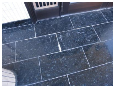
1. 目地と石からエフロ発生
