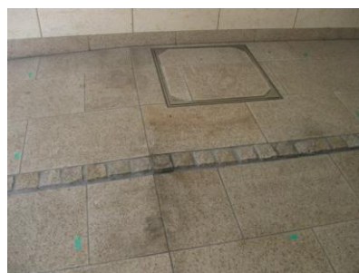
1. 御影石の裏面からの濡れジミ
