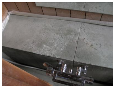
1. 表層劣化の進んだ伊豆石
